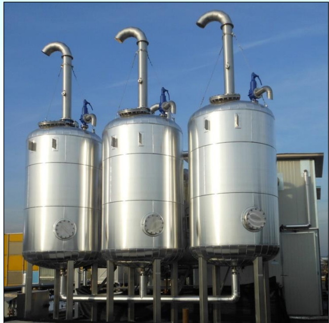
Impianto da 5000 m 3 /h
