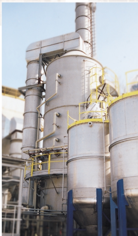
Impianto di depurazione fumi da inceneritore Incinerator fumes purification plant
