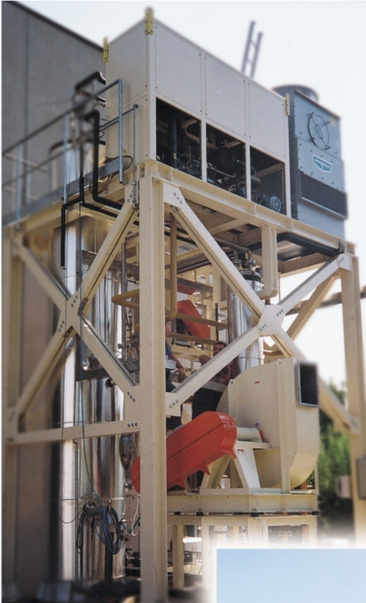
Torre di lavaggio ad acqua sottoraffreddata Scrubbing tower with cooled water
