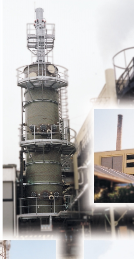
Torre di lavaggio acido/basico Acid/basic scrubbing tower
