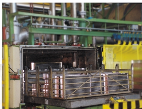
Fase di carico della camera di sgrassaggio Loading phase of degreasing chamber
